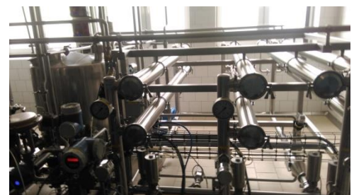
Afbeelding 12: Installatie in melkfabriek
